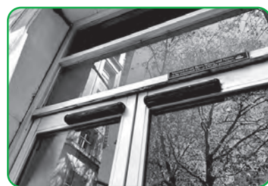
左右両方の扉にセンサーが設置されている
